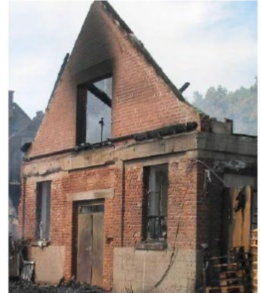
Abbildung 13_Giebelwand nach Brand, FF Gensingen
