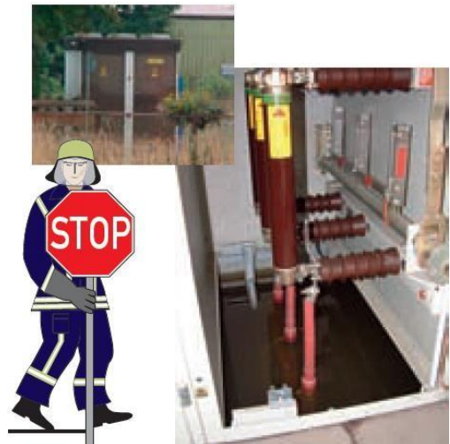
Bild 6: Überflutung von Transformator
