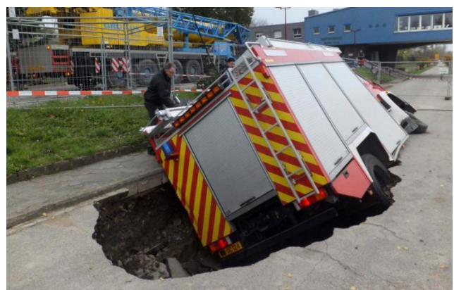
Bild 16: Einsatzfahrzeug hat die unterspülte Straßendecke durchbrochen
