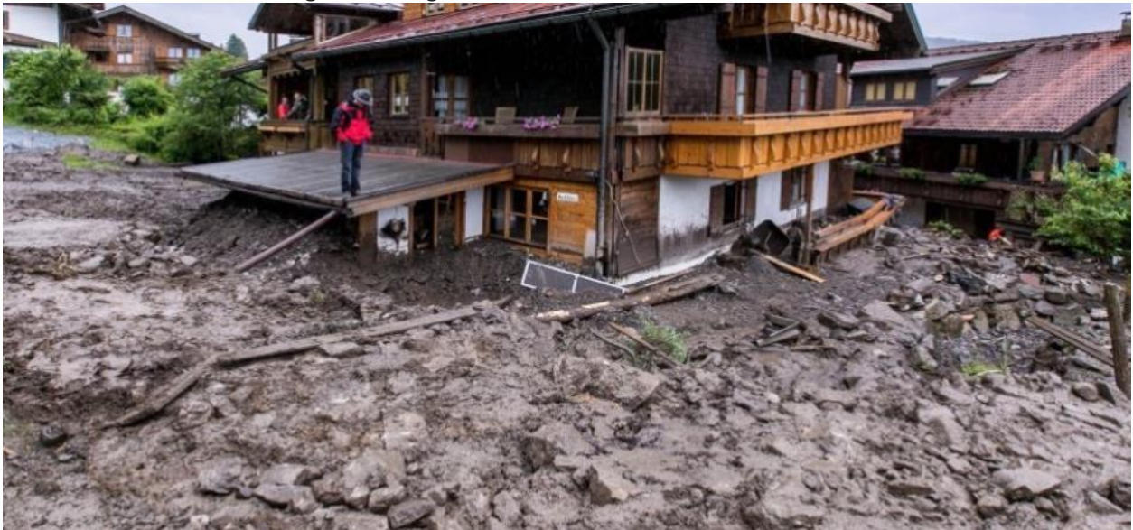
Bild 27: Erdgeschoss wurde nach Schlammlawine verschüttet
