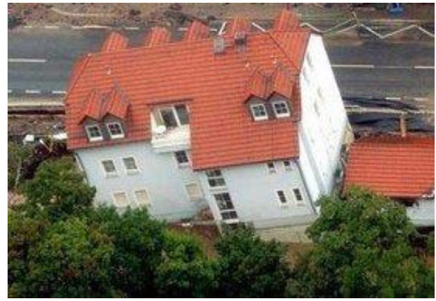
Bild 18: Unterspülung eines Gebäudes Feuerwehrfahrzeug
