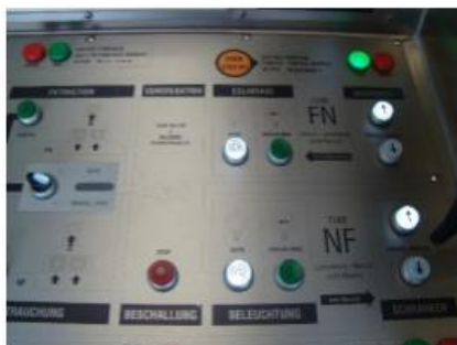
Bedienpult am „Coffret Pompiers“
