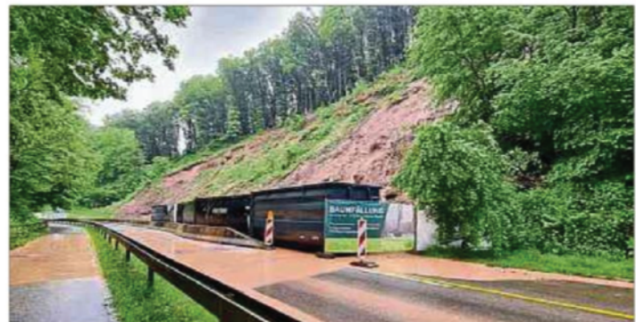
Zwischen Rosport und Steinheim kam es zu einem Hangrutsch. LW-Informationen nach soll die N10 an dieser Stelle bis kommenden Dienstag gesperrt bleiben müssen. Foto: Nadine Schartz
